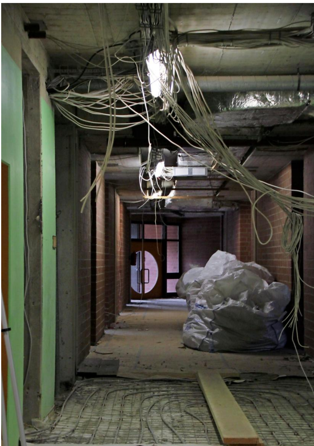
Herabhängende Kabel, geöffnete Böden: So sieht die Mittelschule von innen aus.
