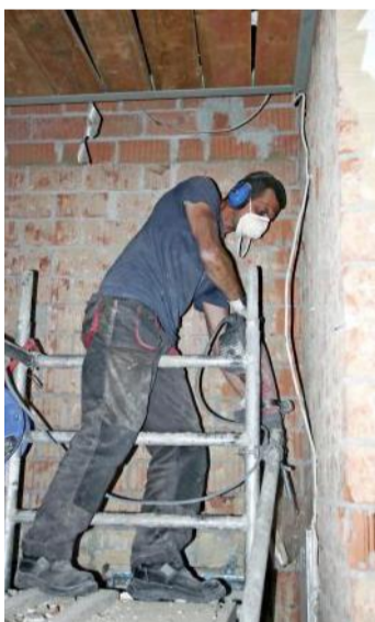
Mit der Hand stemmen Arbeiter den Putz von den Wänden. Der Schutt wird in Eimern getragen.
